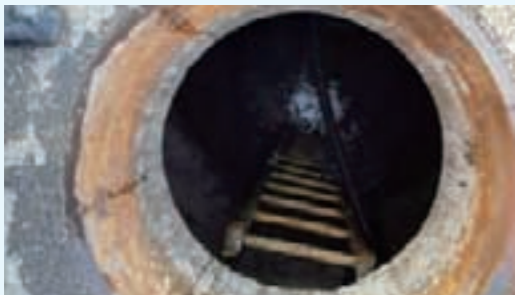
2017.06.22 사망 2명 하수관거 정비공사 (맨홀 내부 점검 후 산소 결핍(또는 유해가스 중독 추정)으로 의식을 잃고 추락)
